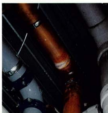
まったく被害のなかった銅管
