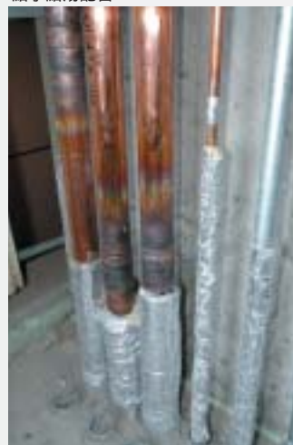
給水給湯配管
