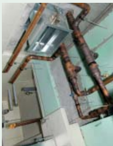
給水給湯配管
