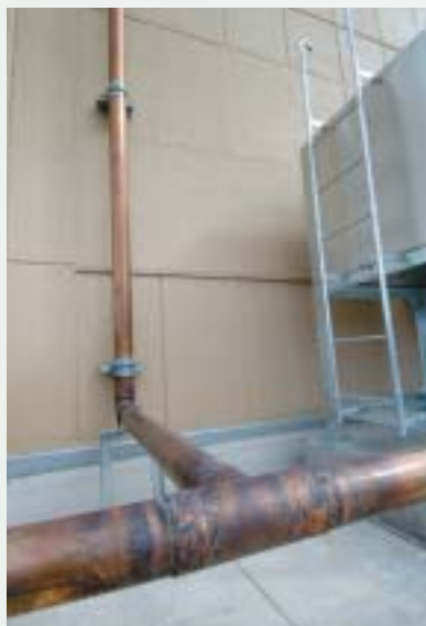
屋上の高架水槽と銅配管
