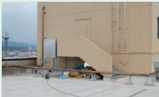
屋上の高架水槽と銅配管
