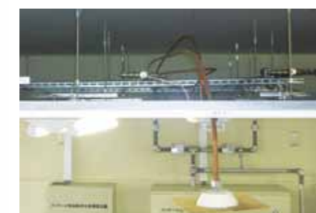
施工性に優れた銅管を使用（天井裏配管の様子）
