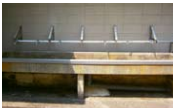
直結給水に切替えられ、 きれいに一新された水飲み場
