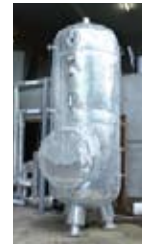
温度成層式蓄熱・貯湯タンク「亀山貯蔵(ためぞう)」
