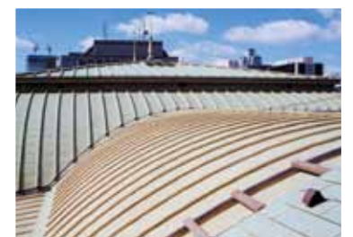
大阪市中央公会堂の銅屋根の改修には 18トンもの緑青銅板が使用された
