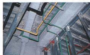
医療ガス配管
