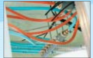
天井配管の様子
