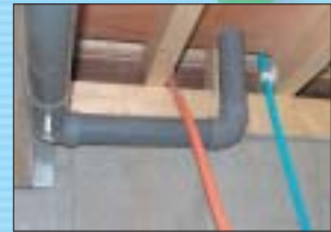
給水・給湯配管
