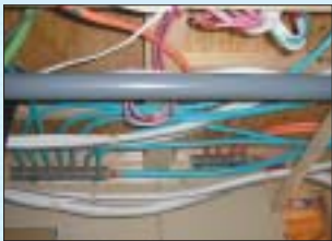
天井配管の様子
