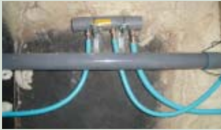
モデルハウスで使用された銅配管
