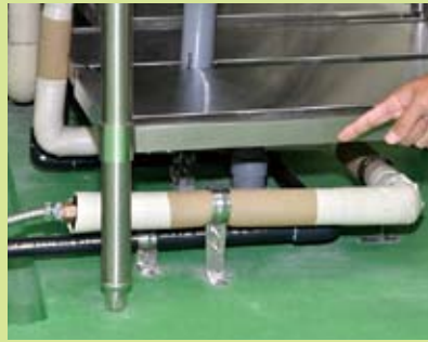
厨房内の給湯管に使用した被覆銅管
