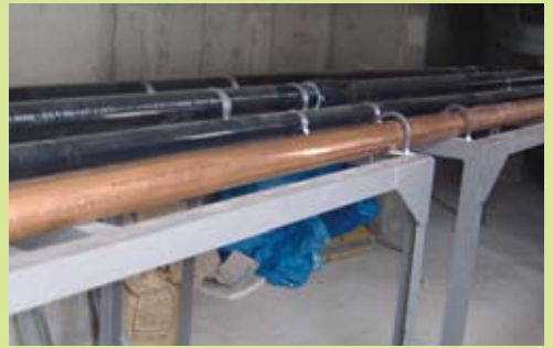
大口径の銅管が院内を走る
