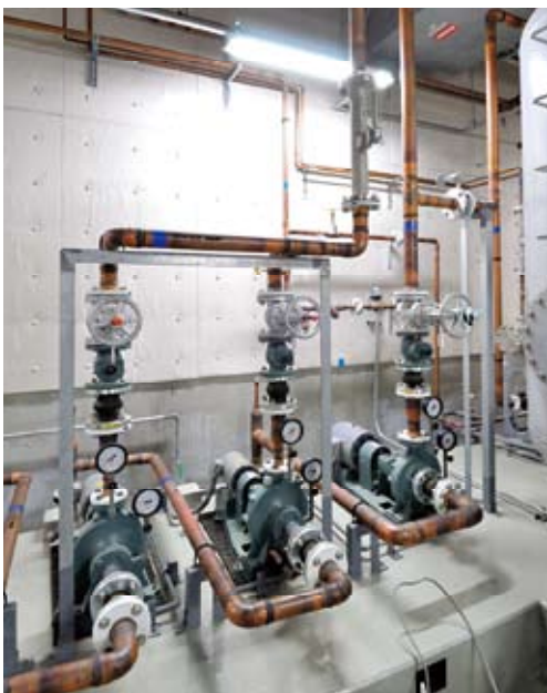
1号館地下の機械室に設置された銅管
