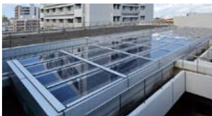
吹き抜けの天井には外光も取り入れられる太陽光発電を設置
