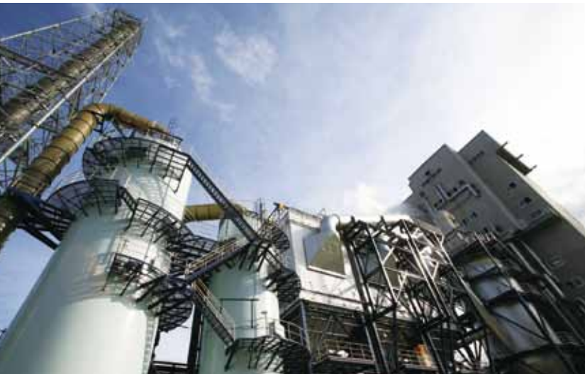
2007年夏、小坂製錬に完成した新型のTSL炉
