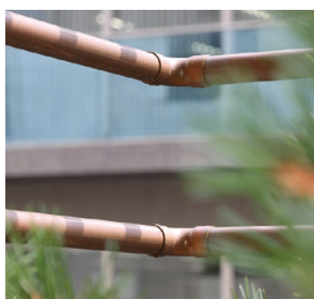
コーナーの銅管接合部
