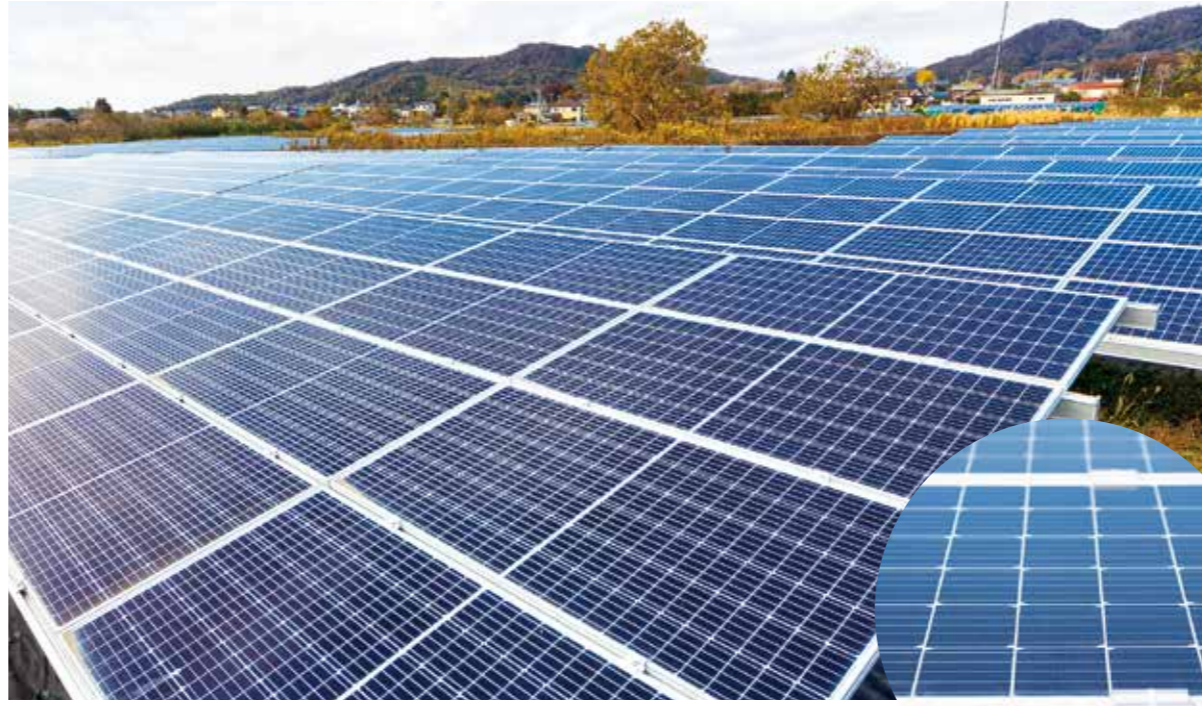
2018年2月に完成した段子田太陽光発電所。DC:1134kw、AC:567kwの発電能力を有している。
