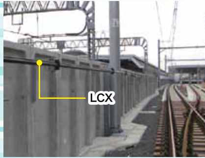
車窓の高さあたりに布設された漏洩同軸ケーブル(LCX)は、車内から見る事ができる。車両はケーブル沿いを走行するため、常に快適な通信環境を保持できる。
