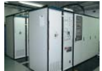
送信機室 送信信号を増幅する大電力送 信機を備えている
