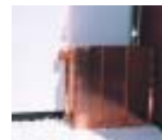
設置された中水利用銅製タンク
