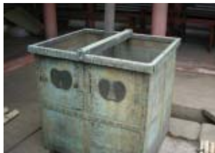
銅製雨水受水槽
