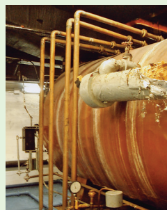
ホテル内給水・給湯はすべて銅管
