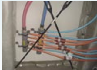
ヘッダー部から細径の被覆銅管を分岐し、各蛇口へ直接配管している
