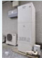
エコキュートの屋外給湯器
