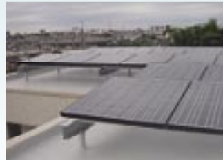
屋上に設置した多数の太陽電池パネル間を導電率の高い銅線をつないでいる
