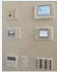
発電状況、売り電力、買い電力の数値がモニターに
